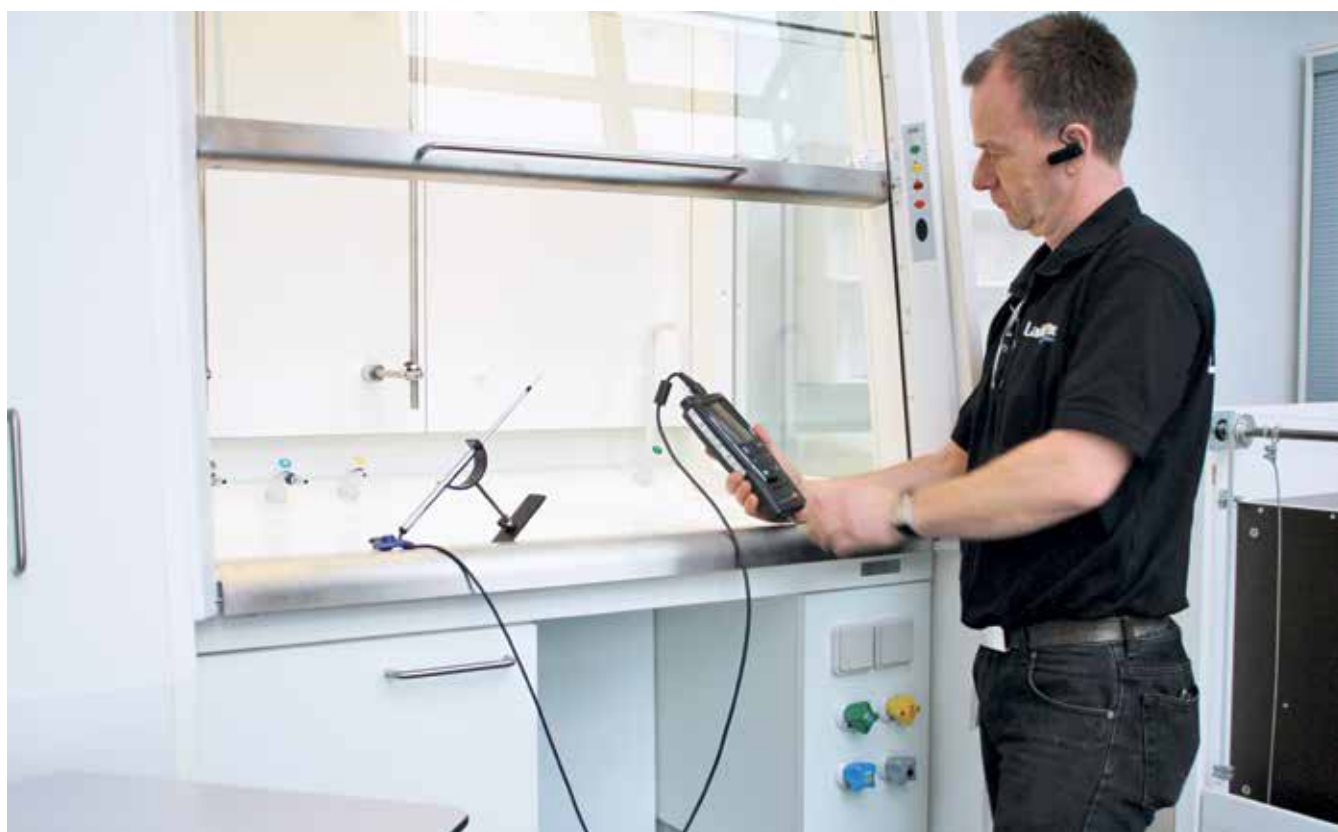
Figur 21. Lufthastighedsmåling i et stinkskab.
